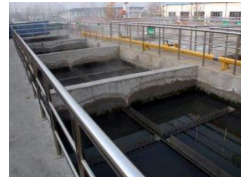
(f) 污水处理池
